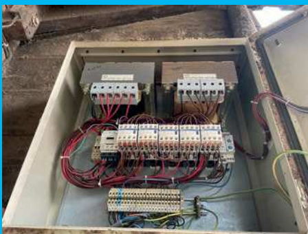
LE TABLEAU ÉLECTRIQUE QUI ALIMENTE L'ARMOIRE DES VENTILATEURS EN 380 VOLTS AVEC UN CÂBLE QUATRE CONDUCTEURS (TROIS PHASES + TERRE) SANS LE CONDUCTEUR NEUTRE.
