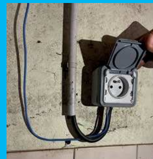
EN REPIQUANT LE NEUTRE ET SUR LA PRISE DE COURANT DE 220 VOLTS POUR ALIMENTER LA SONDÉ DES VENTILATEURS, L'INSTALLATEUR A CRÉÉ UN CHAMP ÉLECTRIQUE ET ÉLECTROMAGNÉTIQUE CONSIDÉRABLE.
