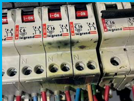
LE CONTACTEUR UNIPOLAIRE QUI ALIMENTE LE RÉSEAU 220 VOLTS DE LA PRISE DE COURANT, QUI, VIA UN RETOUR DU COURANT SUR LE NEUTRE, A OCCASIONNÉ DES SURCHARGES ÉLECTRIQUES.
